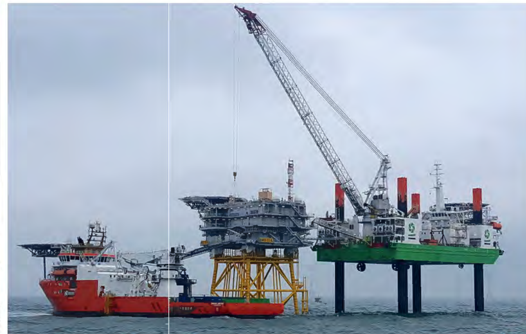
Transformator op zee
